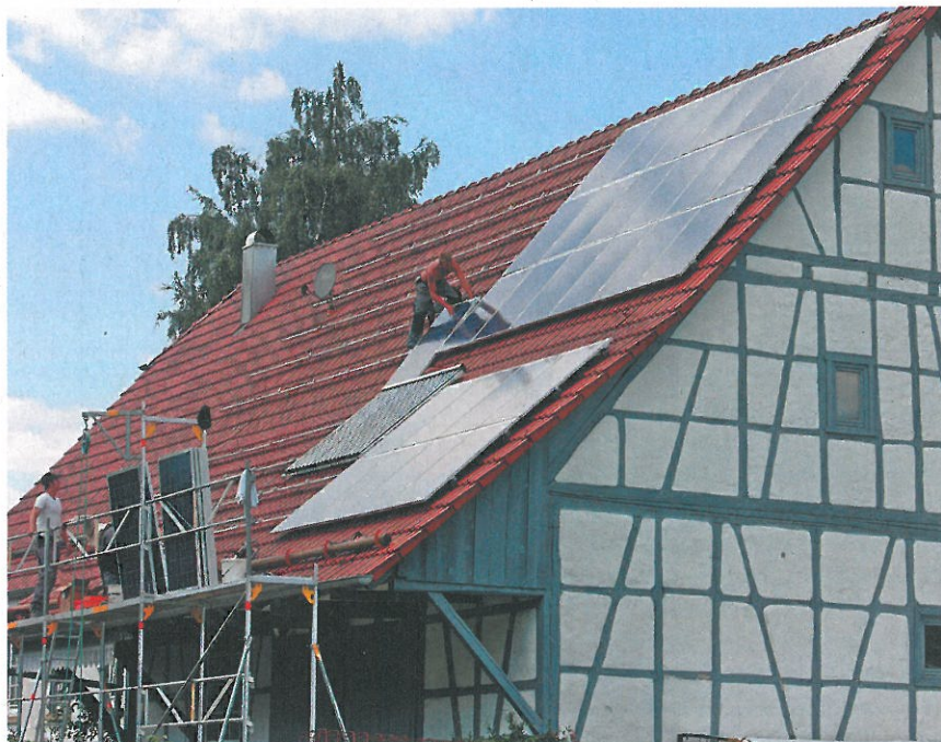
Installation einer Solarstromanlage: Bestandteil des Gebäudes?
